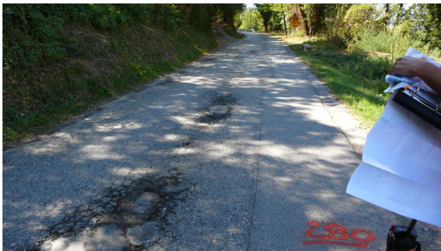
Slika 3: km 0,280 – stanje vozišča
