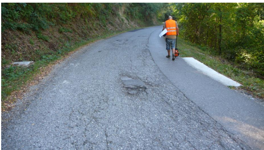
Slika 11: km 1,560 – cevni prepust in stanje na vozišču
