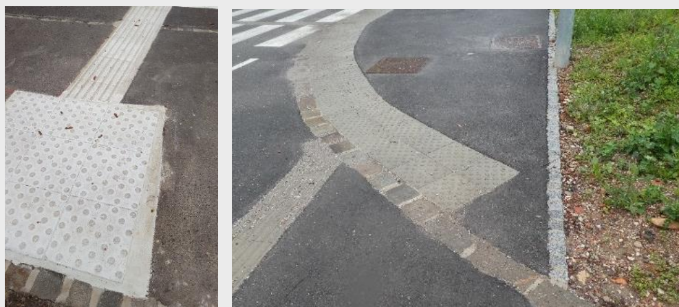
Sliki 14 (neustrezno): Primera nenatančne izvedbe taktilnih oznak. 1: Izvedba z načinom naknadne vgradnje. Izrez za taktilne oznake je bil prevelik glede na predvidena polja. Vsaka dodatna zapolnitev z različnimi materiali pomeni več neravnin v tleh, kar je neustrezno tako za tipno zaznavnost kot tudi za prevoznost s pripomočki na kolesih. 2 (neustrezno) Izvedba z načinom predhodne vgradnje, pri kateri je bila struktura ob asfaltiranju zelo poškodovana, taktilne oznake pa niso bile izvedene do roba. Če hodi uporabnik bele palice ob robu zelenice, je zelo verjetno, da čepastih oznak ne bo zaznal – opozorilni čepasti pas tako ne bo opravil svoje funkcije.
